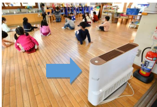
＜写真 26＞ターンド・ケイ(KL-F01) 幼稚部園舎内に設置
