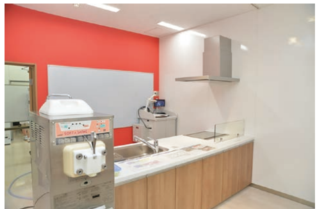
教卓前にはアイスクリーム実習用のソフトクリームフリーザーが使えるよう3相200V電源、給排水を設備
