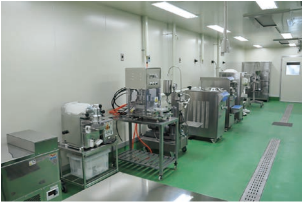
製造機器が搬入されたクリーンルーム
