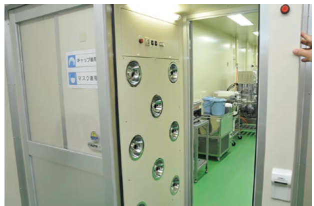
塵や毛髪持ち込み防止のためエアシャワー設置
