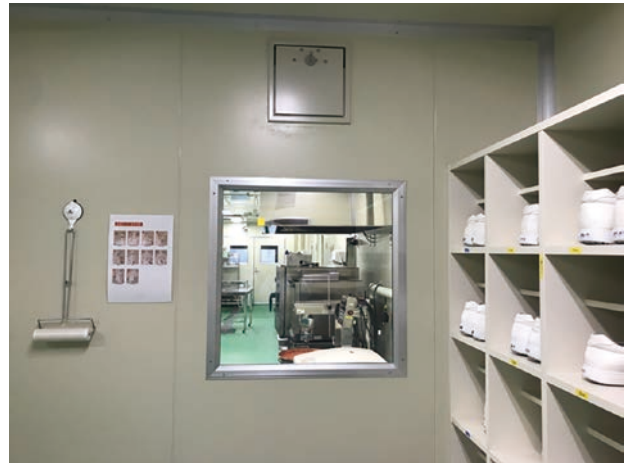
差圧ダンパー、窓枠は埃除けの斜めカット仕様 入口でクリーンルームについて学生に解説
