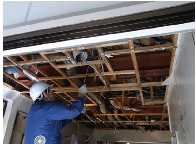
解体で天井裏高の不足が判明、HEPA 機器の設置に難航
